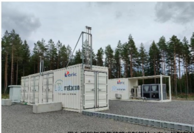
图为派瑞氢能集装箱式制氢站（左）与制氢站旁风机（右）
