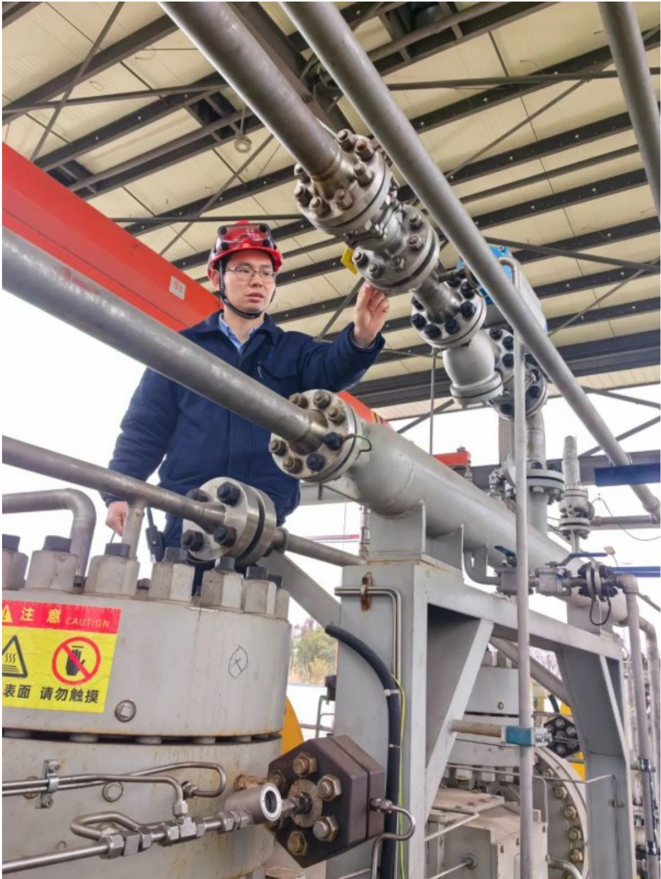
检查氢气长管拖车安全附件
